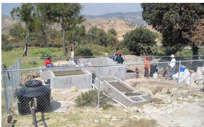
Vista panorámica de la planta FIME Peregrina.
