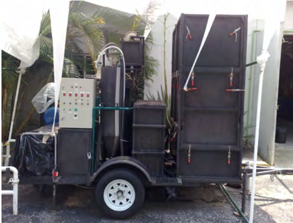
Planta instalada en la granja porcícola de Jojutla, Morelos.
