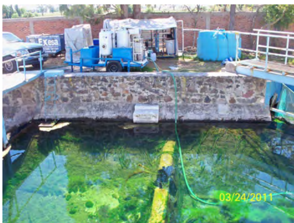
Vista de la planta piloto instalada en el Cerro Colorado.
